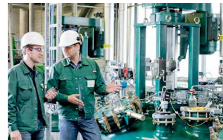
Veresterungsreaktoren in der Biodieselerstellung. Esterification reactors for the biofuel production. (Photo: VERBIO AG)
